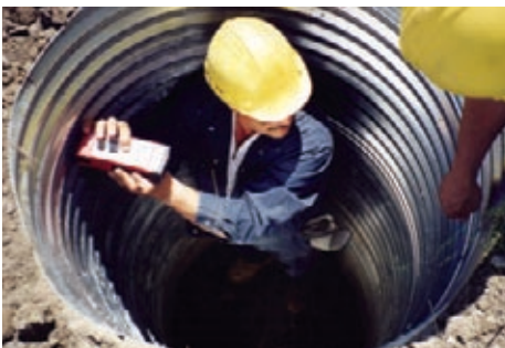
Figure 3 – Mesure des déformations du TAOG
