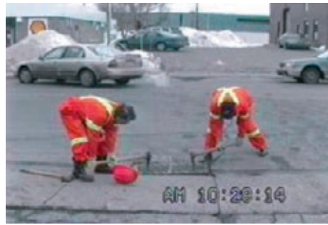
Levée d'une grille à rainures obliques avec un pic
