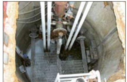
Puits mouillé d'une station de pompage d'eaux usées
