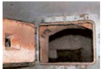
Four / Chaudière / Incinérateur
